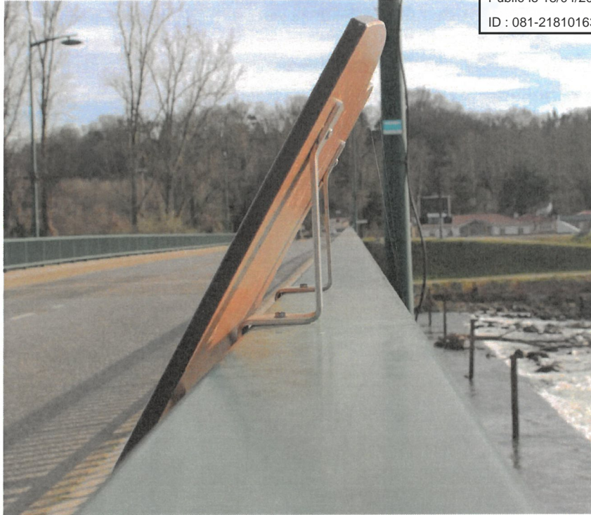
Fixation du panneau via une paire de cornière Inox et un système de boulonnage sur la face arrière
